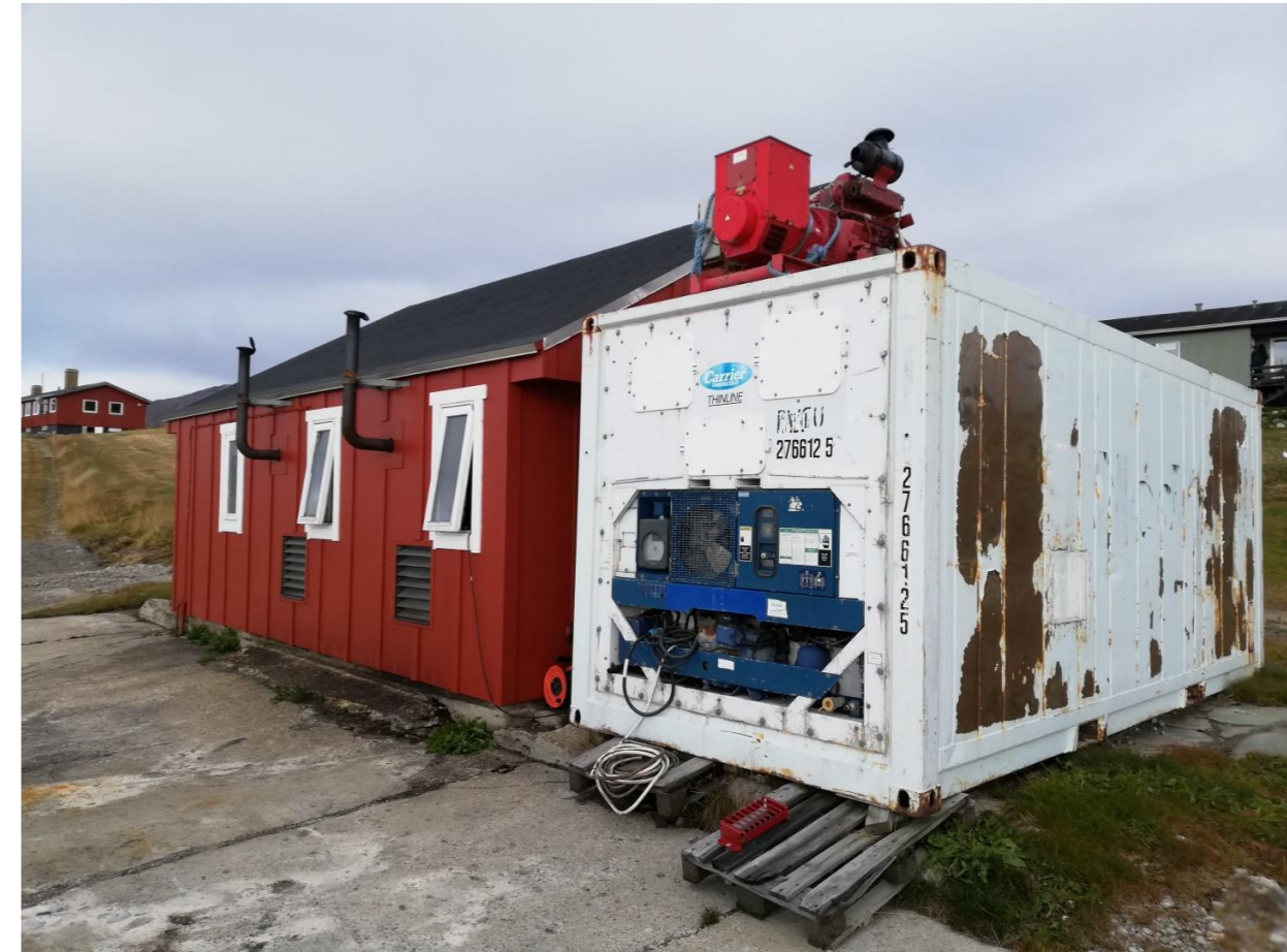
Eksisterende elværk og opbevaringscontainer
